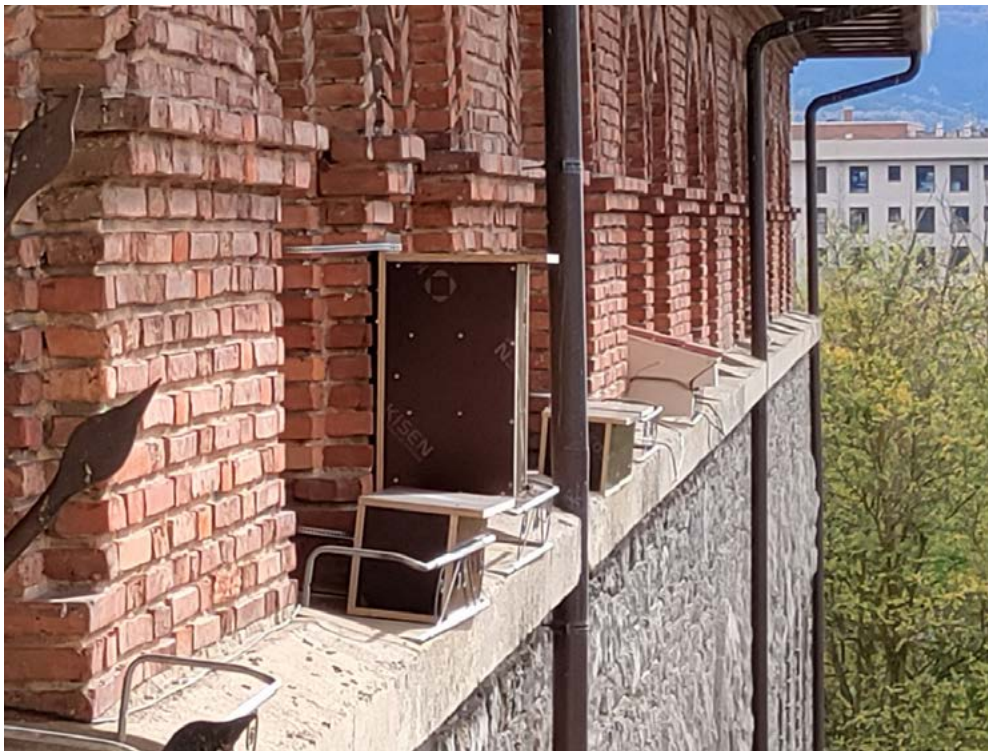
Vista parcial de los distintos tipos de cajas para vencejo en las ventanas del IAN.
