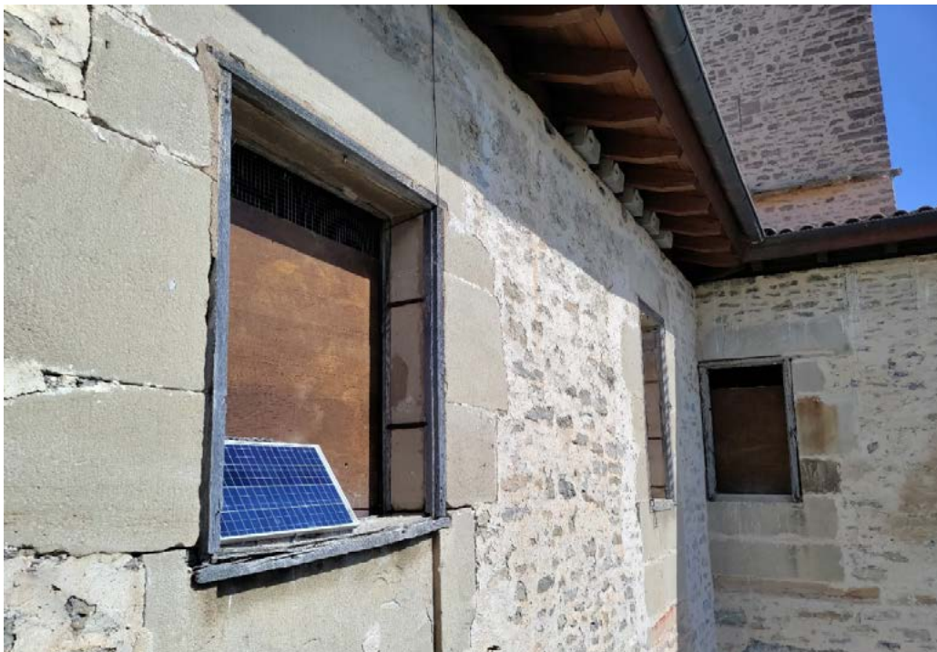
Instalación automática de reclamos de vencejo en Mártioda.
